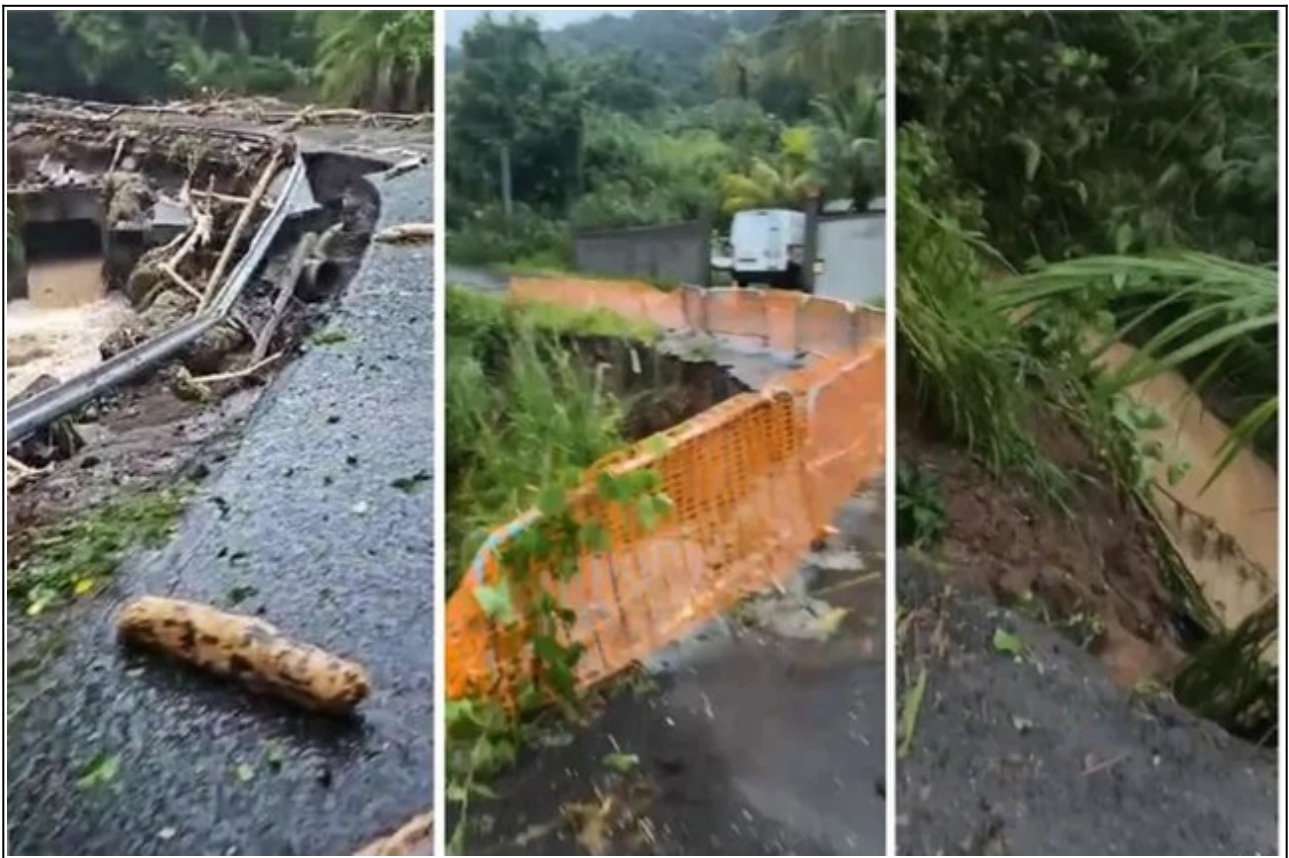
Effondrements de chaussée dans le Sud Basse-Terre (Crédit photo : Guadeloupe La 1ère)
