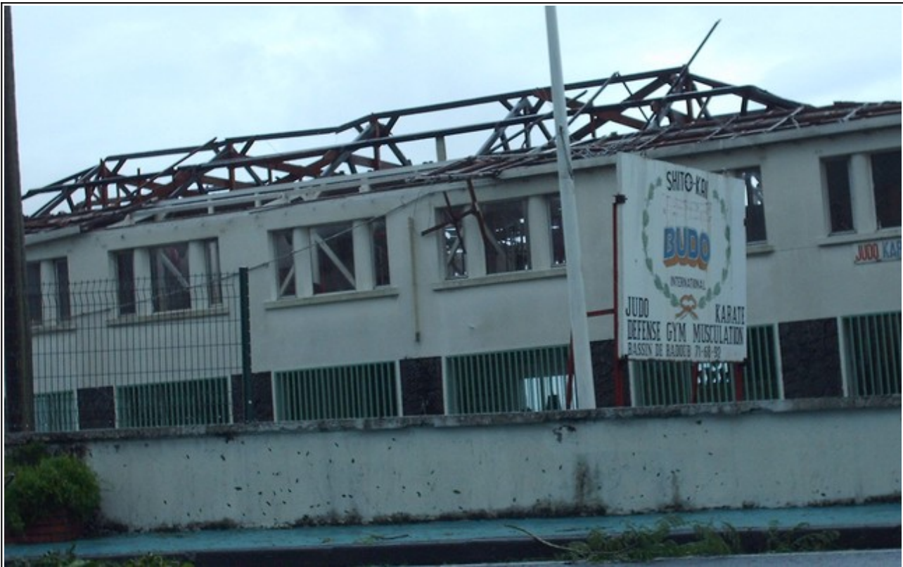
Toiture arrachée par le vent à Fort-de-France (Crédit photo : Christophe Vilna)
