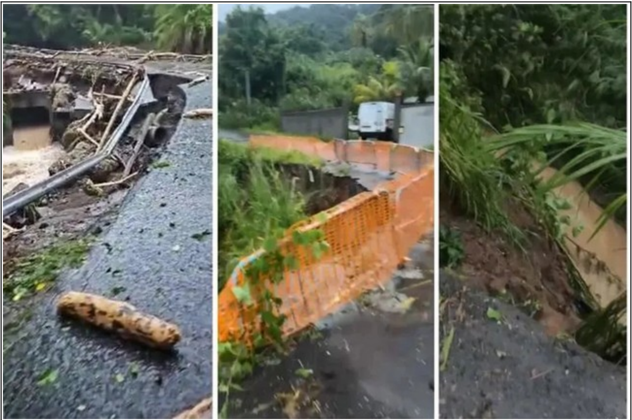
Effondrements de chaussée dans le Sud Basse-Terre (Crédit photo : Guadeloupe La 1ère)
