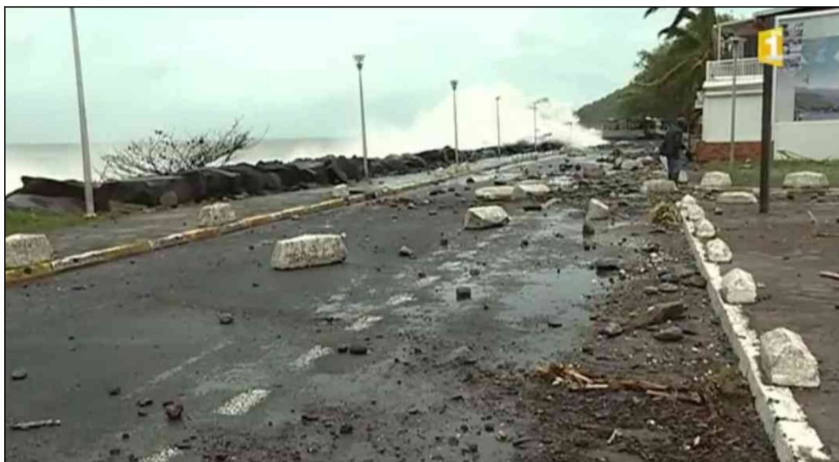
Dégâts causés par la houle cyclonique - Commune de Bouillante - Guadeloupe (Auteur inconnu - Droits réservés) - Reproduction interdite
