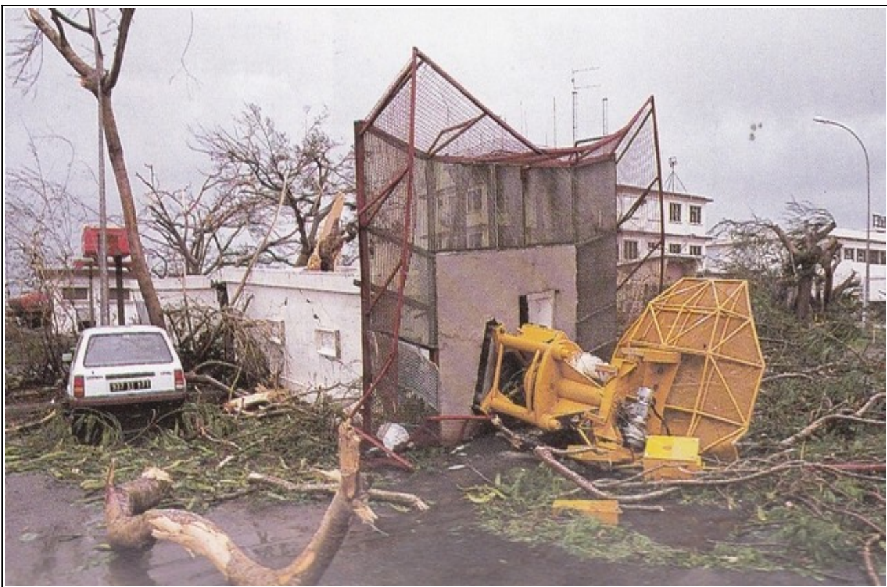
À l'aéroport du Raizet, le radar météorologique et sa tour en béton qui le soutenait brisés par le vent vers 0 h 30 locales, alors que l'œil de HUGO se trouvait sur l'est de la Grande-Terre (Crédit photo : service météorologique de Guadeloupe)
